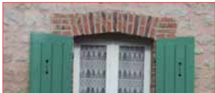
Jour de ventilation.
